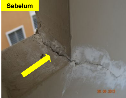
Gambar 1.20 Keretakan Dinding Di Ruang Legar
