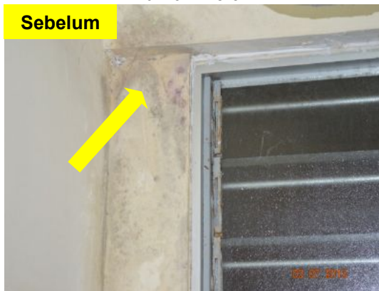
Gambar 1.24 Kesan Resapan Air Pada Dinding Rumah C6/01
