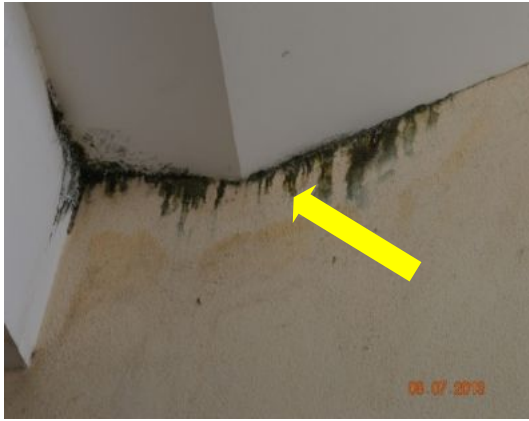
Gambar 1.38 Kesan Resapan Air Pada Dinding Rumah C6/01
