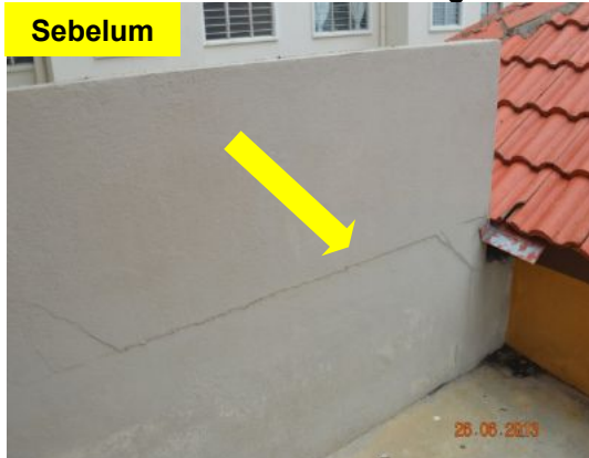
Gambar 1.22 Keretakan Pada Tembok Di Tingkat Atas
