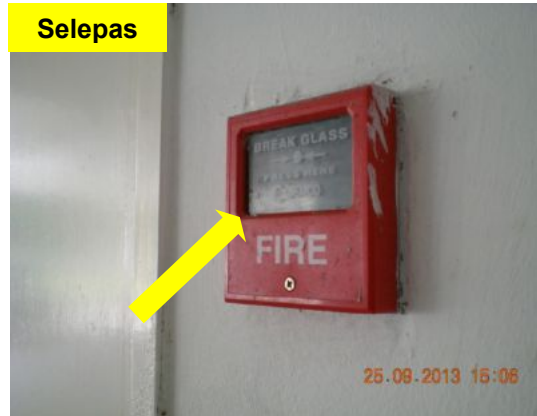
Gambar 1.51 Fire Break Glass Telah Dibaiki
