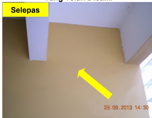
Gambar 1.15 Keretakan Pada Tiang Sokongan Yang Telah Dibaiki
