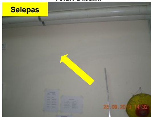
Gambar 1.17 Keretakan Pada Dinding Telah Dibaiki
