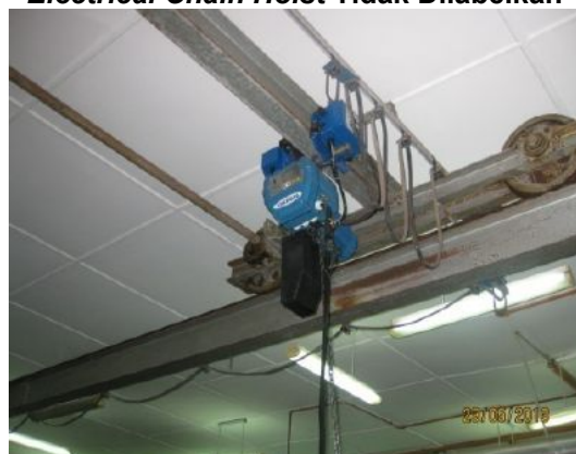
Gambar 3.9 Electrical Chain Hoist Tidak Dilabelkan
