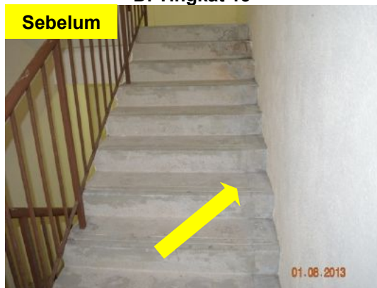
Gambar 1.18 Keretakan Pada Anak Tangga Di Tingkat 13
