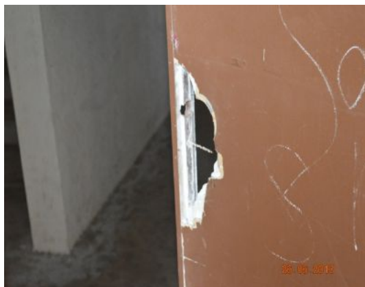
Gambar 1.54 Pintu Rintangan Api Dirosakkan
