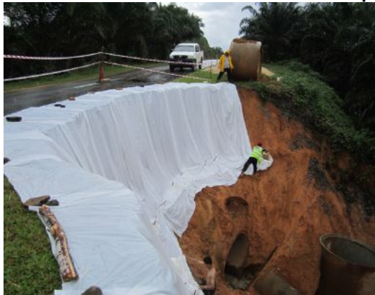
Sumber: Syarikat Konsesi Lokasi: Jalan Sungai Bari/Ladang Bari, Setiu (Seksyen 1.3) Tarikh: Tidak Dinyatakan
