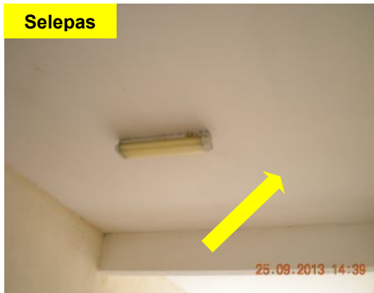
Gambar 1.31 Kesan Resapan Air Telah Dibaiki
