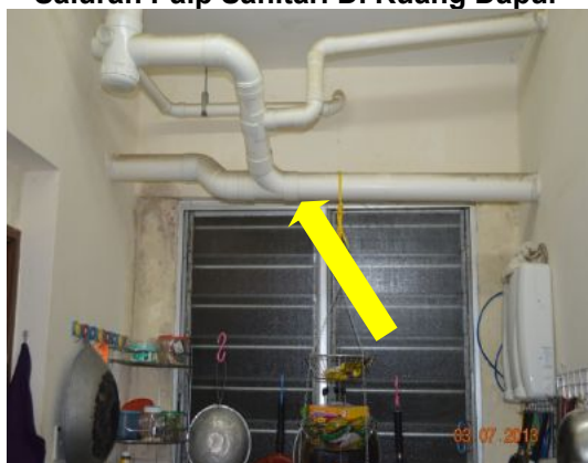
Gambar 1.44 Saluran Paip Sanitari Di Ruang Dapur
