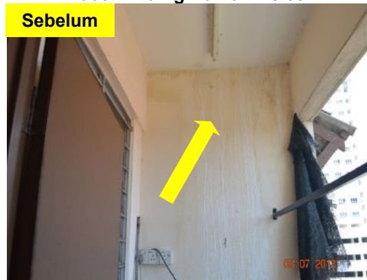
Gambar 1.28 Keretakan Dan Kesan Resapan Air Pada Dinding Rumah C5/09
