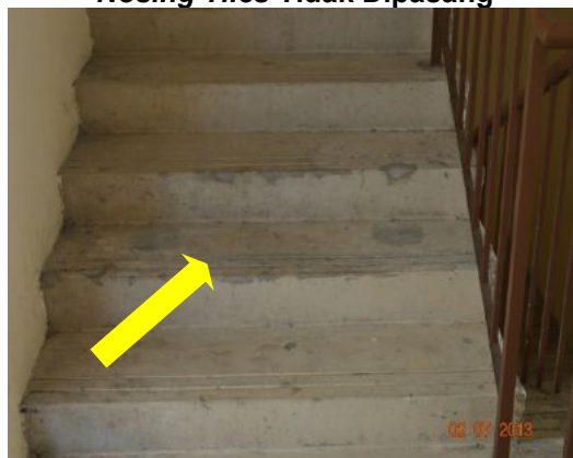
Gambar 1.9 Nosing Tiles Tidak Dipasang
