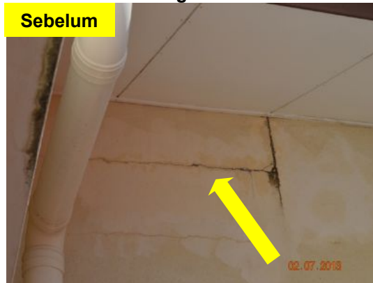
Gambar 1.26 Keretakan Dan Kesan Resapan Air Pada Dinding Rumah C6/01
