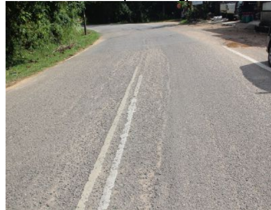
Gambar 2.18 Kerosakan Permukaan Jalan (Ravelling)
