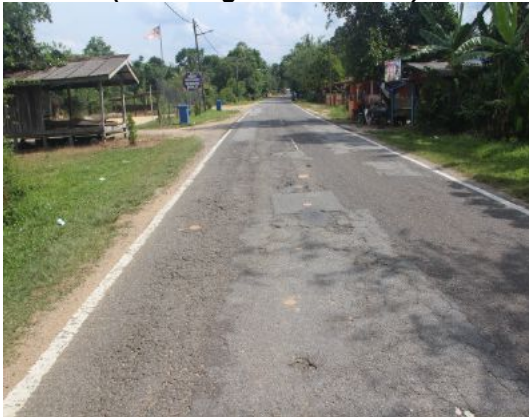
Gambar 2.17 Kerosakan Permukaan Jalan (Ravelling Delamination)
