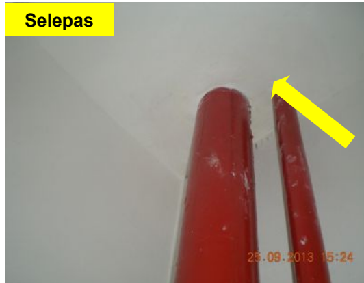
Gambar 1.35 Lepaan Tidak Rata Telah Dibaiki
