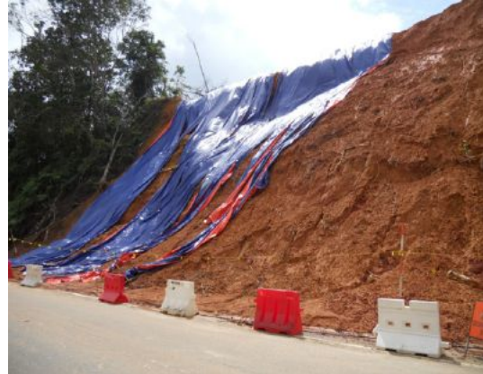
Sumber: JKR Daerah Kemaman Lokasi: Jalan Teladas, Air Putih, Kemaman (T18 Seksyen 0.1) Tarikh: 26 Disember 2012
