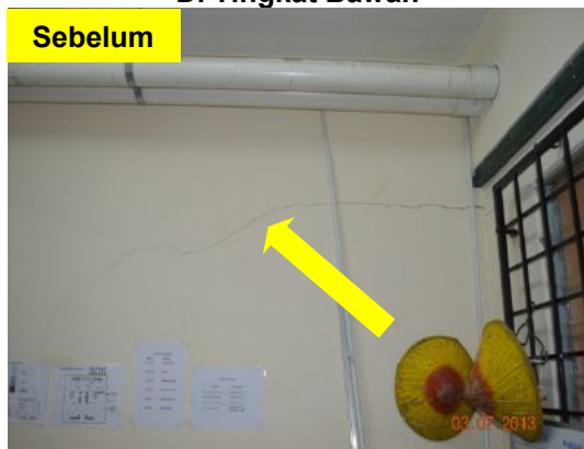
Gambar 1.16 Keretakan Pada Dinding Di Tingkat Bawah
