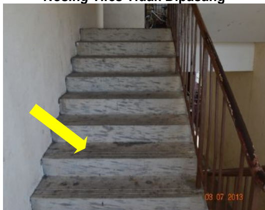
Gambar 1.8 Nosing Tiles Tidak Dipasang
