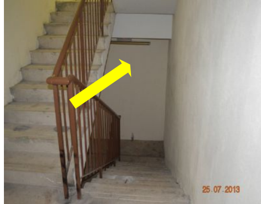
Gambar 1.42 Tangga Kecemasan Tidak Ada Tingkap Pengudaraan
