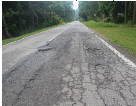
Gambar 2.14 Keretakan Jalan (Retak Blok)
