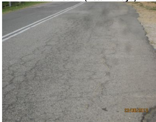
Gambar 2.13 Keretakan Jalan (Retak Buaya)
