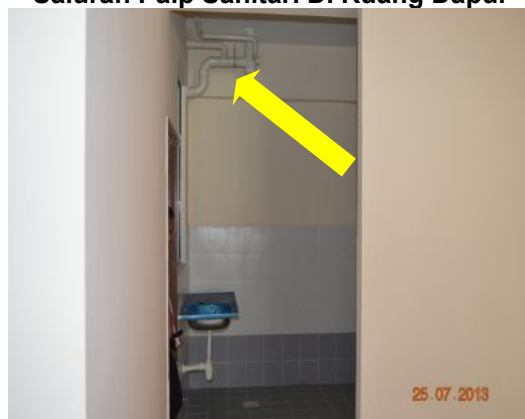
Gambar 1.45 Saluran Paip Sanitari Di Ruang Dapur
