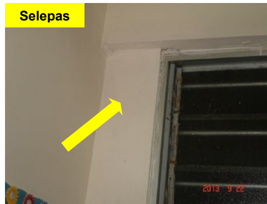
Gambar 1.25 Kesan Resapan Air Telah Dibaiki
